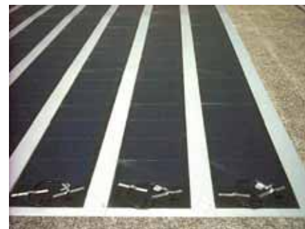
Copertura con pannelli fotovoltaici flessibili
