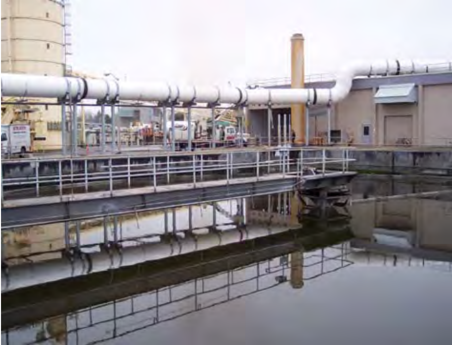
Particolare di un impianto di depurazione (foto en.academic.ru)
