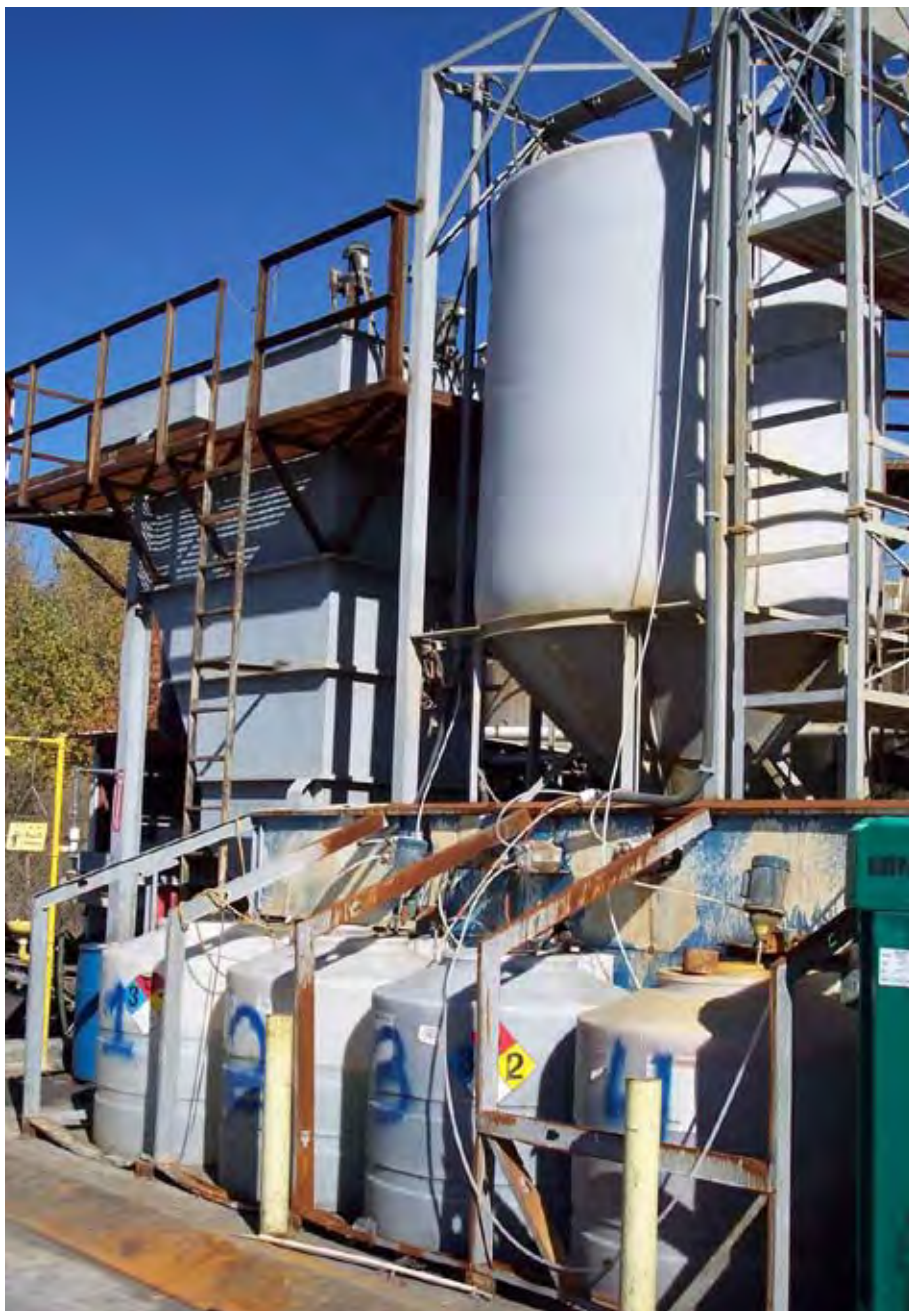
Sistema di trattamento delle acque reflue a Dallas, Usa (foto Dallas City Hall)
