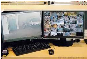
Una centrale di controllo delle telecamere
